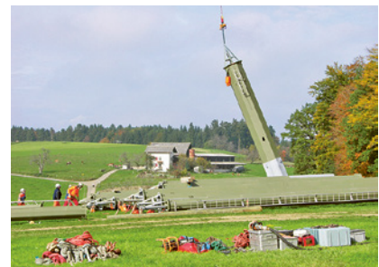
3 Aufenthalt unter der schwebenden Last vermeiden.
